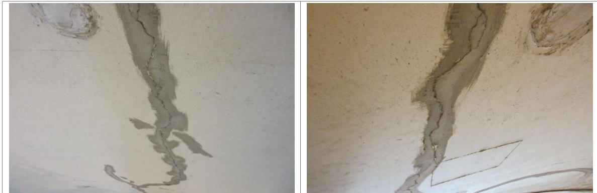
S71 천단부 종방향 보수부재균열
